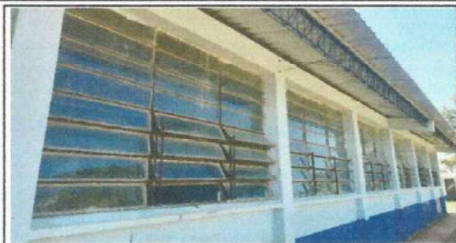
Foto 1: Se observa que las ventanas del lado trasero del edificio No. 2 se encuentran en mal estado, presentando deterioro en su estructura, cristales rotos y marcos dañados.
