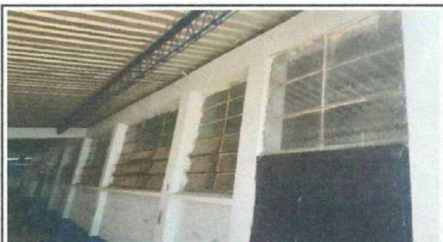
Foto 4: Se observa que las ventanas del lado frontal del edificio No. 1 se encuentra en mal estado.
