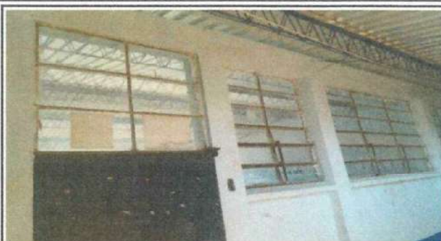
Foto 2: Se observa que las ventanas del lado frontal del edificio No. 2 se encuentra en mal estado.
