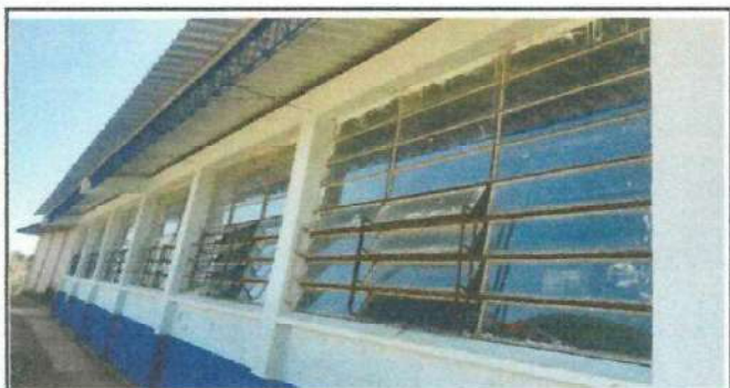
Foto 3: Se observa que las ventanas del lado trasero del edificio No. 1 se encuentran en mal estado, presentando deterioro en su estructura, cristales rotos y marcos dañados.
